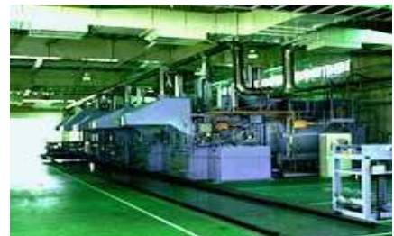
新潟工場熱処理ライン
